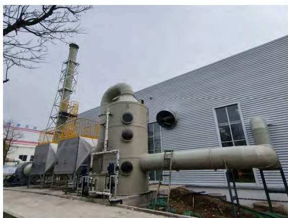
医疗蒸煮废气处理设施
