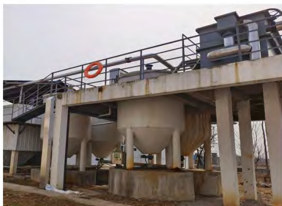
一级、二级沉淀池
